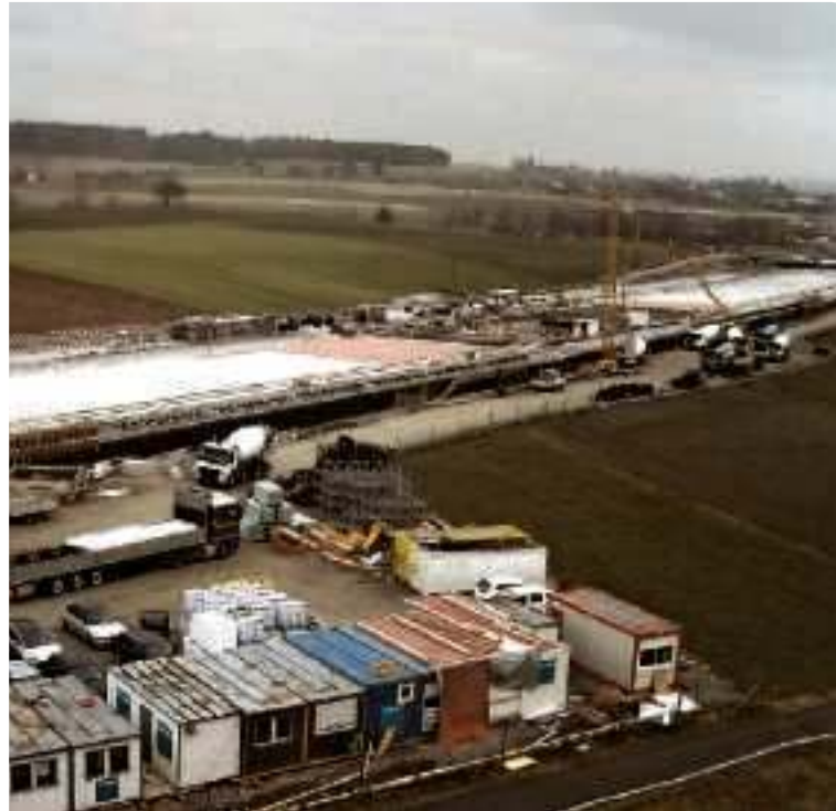
Vereinigung von Affoltern mit dem Katzenssee-Gebiet: An beiden Enden der Überdeckung werden Erholungszone entstehen.
